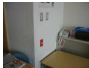
防犯用の警報ベルは、校舎内外に314箇所設置。どこで押されたのかがわかるシステムにもなっている。国立学校ならではの国の予算措置がうかがえる。
