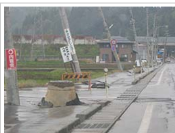
中越地震の液状化被害を見て、本市の対策を質問
